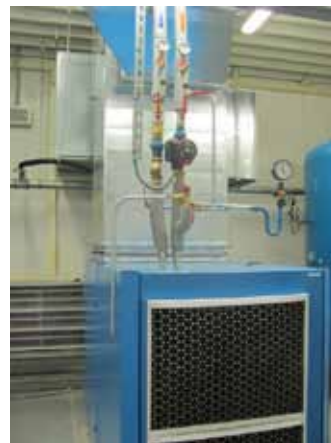
Připojení šroubových kompresorů na rozvod vody ohřáté rekuperační tepla
